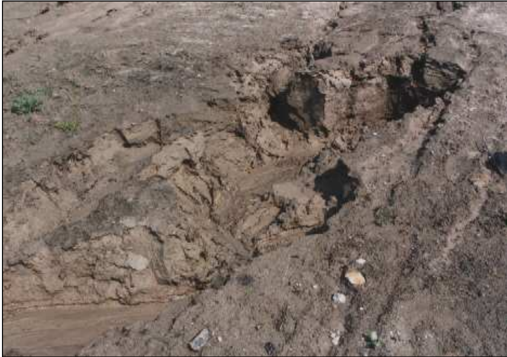
Fot. 5.5 Wyciek wody spod wyprofilowanej części zbocza powodujący erozję powierzchni skarpy (fot. K. Polak)
