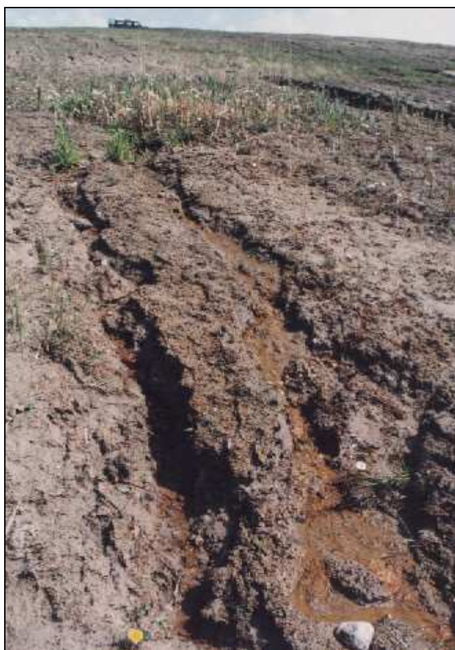
Fot. 5.4 Wysączenie wody ze skarpy powodujące erozję materiału gruntowego (fot. K. Polak)
