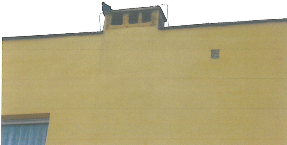
Foto.3. Zabezpieczone siatką otwory kominów wentylacyjnych i otwory wentylacyjne stropodachu. Na kominie widać przesiadujące kawki. Fot. Przemysław Kubacki.
