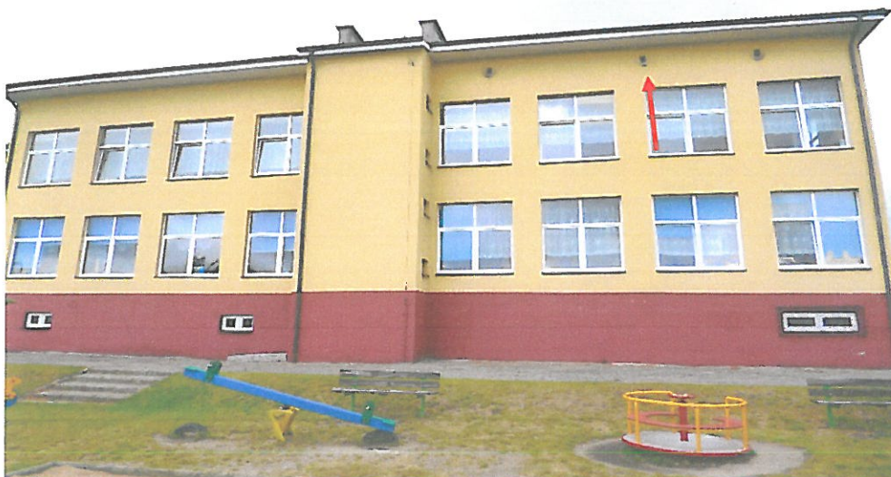
Foto.8. Południowa ściana południowego segmentu budynku, z zaznaczonymi niezabezpieczonymi otworami wentylacyjnymi stropodachu, siedliskiem kawki. Fot. Przemysław Kubacki.
