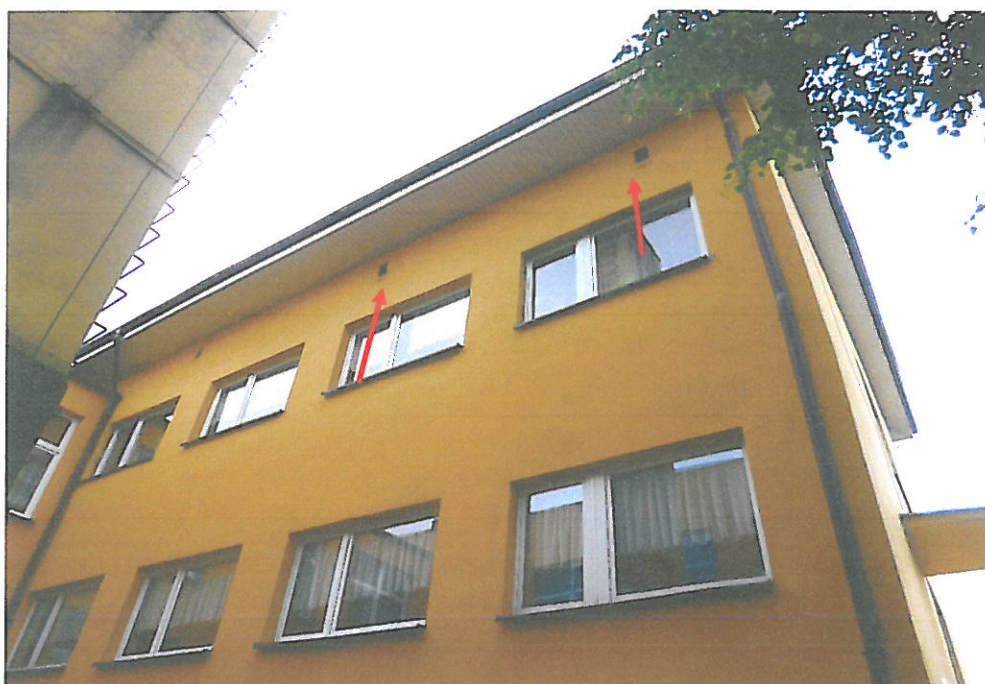
Foto.10. Zachodnia część, północnej ściany, południowego segmentu budynku z zaznaczonymi niezabezpieczonymi otworami wentylacyjnymi, siedliskiem kawki. Fot. Przemysław Kubacki.
