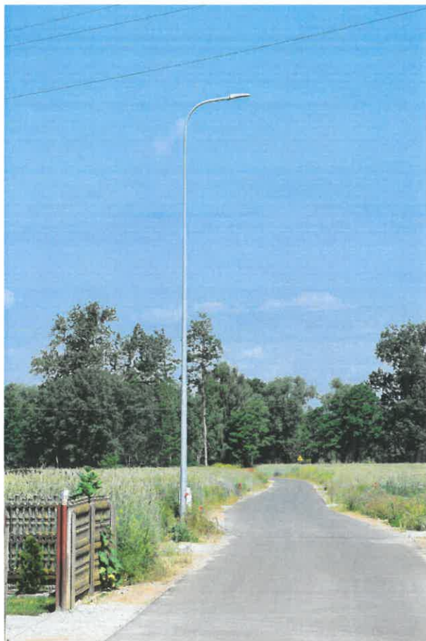
Oświetlenie uliczne - Kuny
