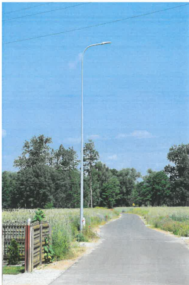
Oświetlenie uliczne - Kuny
