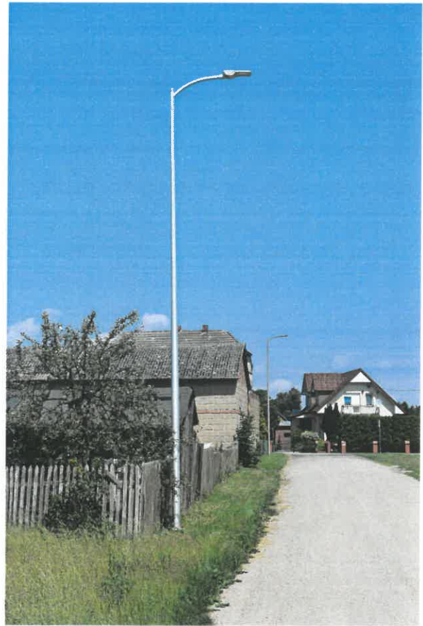
Oświetlenie uliczne – Wyszyzna, ul. Bolesława Chrobrego
